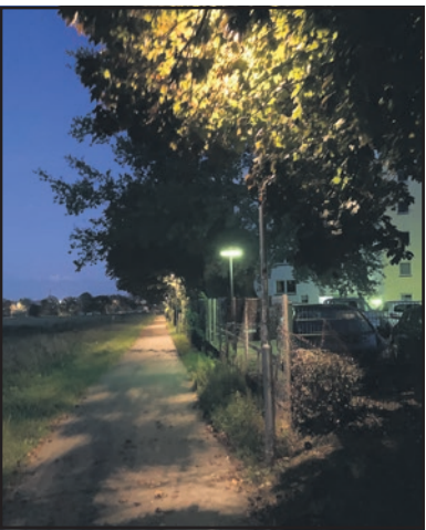
Hier kann die Beleuchtung sich nicht mehr gegen die üppig wachsenden Bäume durchsetzen.
