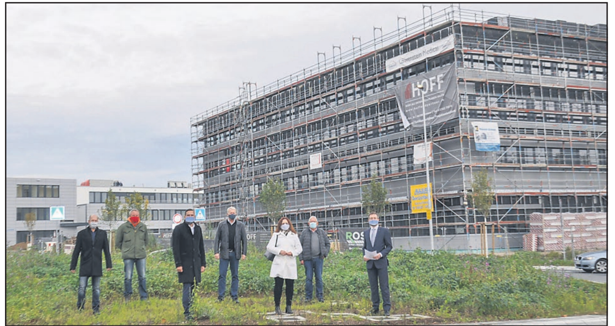
Christian Weber, Büro Sommer Ingenieure; Jürgen Post, Faber & Schnepp; Lars Knobloch, Erster Stadtrat der Stadt Steinbach (Taunus); Michael Schippers, Terramag GmbH; Anika Bodenschatz, Amt für Stadtentwicklung, Bauen & Verkehr; Wilfried Schneider, Terramag GmbH; Steffen Bonk, Bürgermeister der Stadt Steinbach (Taunus) Foto: Terramag GmbH
