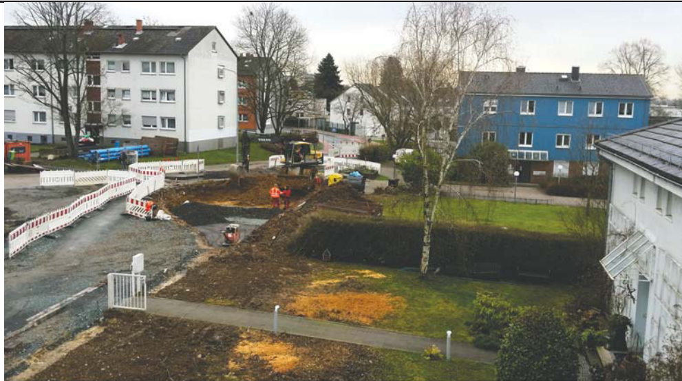
Durch die in den Hessenring hineinragende Fläche, die sog. „Beule“, wird ein gerader Weg mit Parkflächen entstehen. Jetzt ruhen alle Hoffnungen nicht zuletzt auf Fleiß und Tatkraft der vor Ort tätigen Baukolonne, welche die Parkplätze auf dem St. Avertinplatz und die Verkehrsflächen Untergasse/Hessenring, sobald es geht wieder freigeben möge. . .
